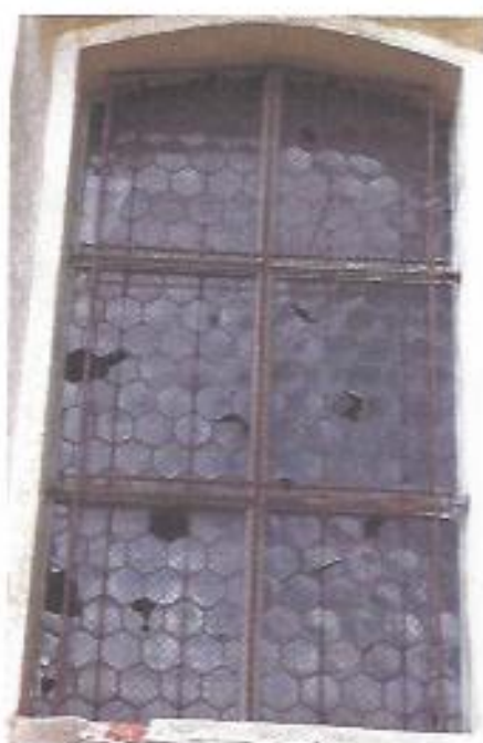
nevhodné řešení vnější ochranné sítě
